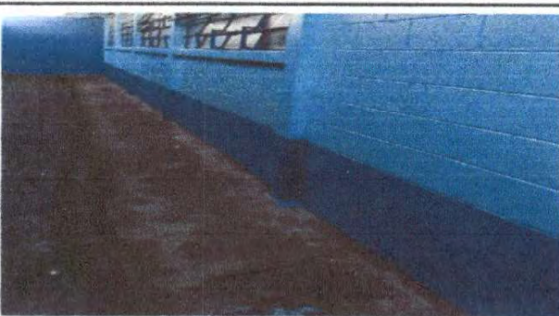
Foto 3: Repello en muro (modulo de aulas)
